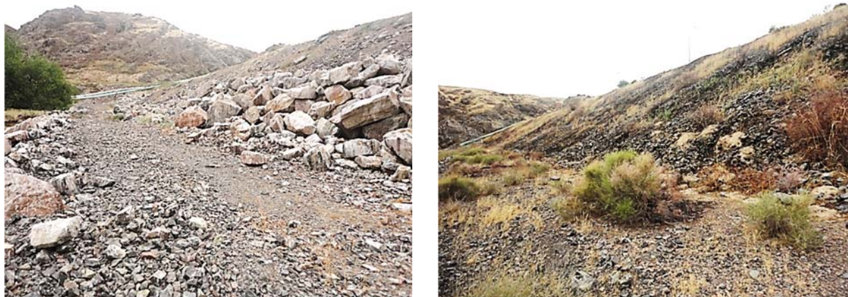
Рисунок 8 - Состояние бермы Куртинской плотины- а)4 ярус ,б)5 ярус
