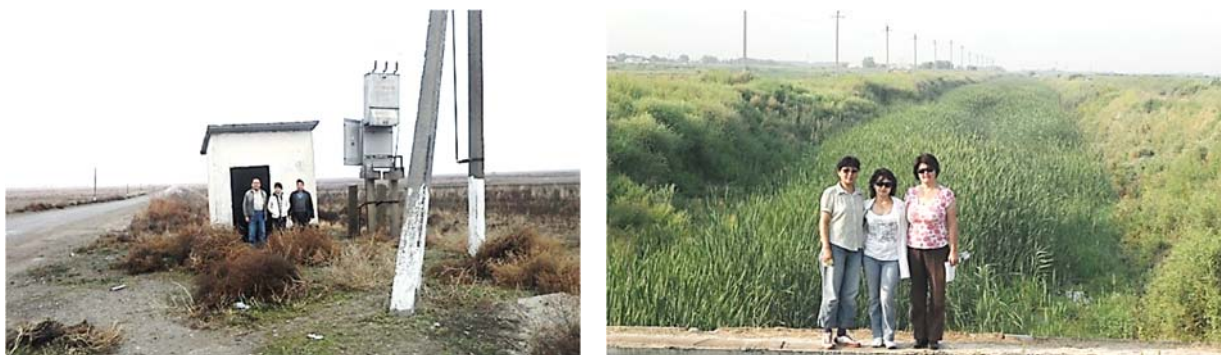
Рисунок 3 – Не работающий СВД и состояние открытого коллектора «Сардоба»
