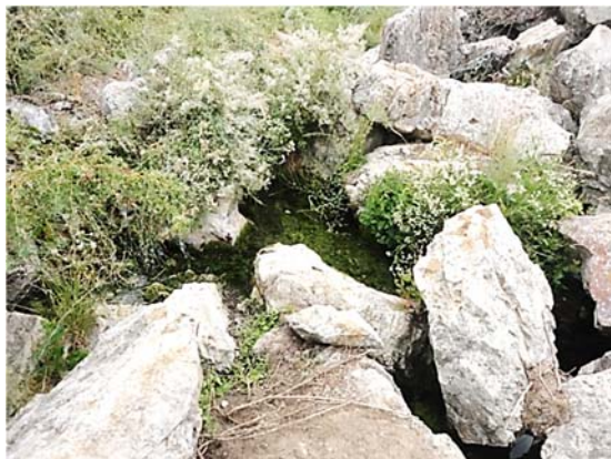
Рисунок 11 - Выход фильтрационных вод из -под дренажной призмы
